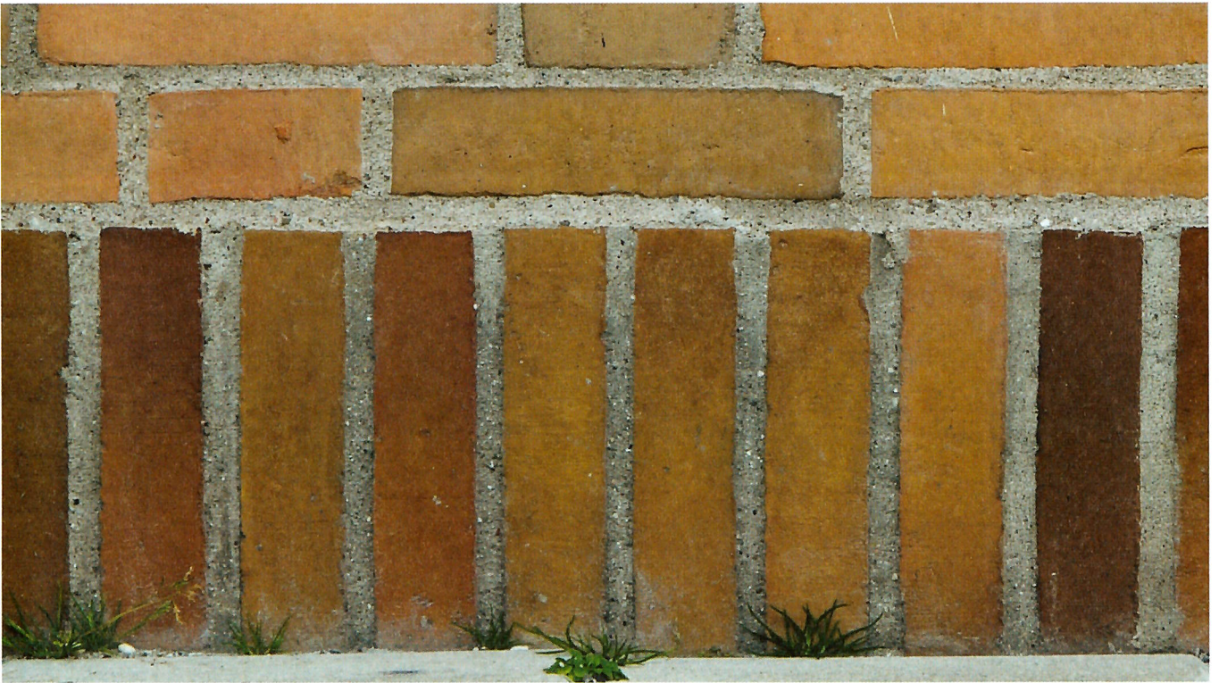
Muret sokkel i standerskifte. Når der er brugt murværk helt ned til terræn, kan det nederste murværk på grund af fugtpåvirkning blive lidt mørkere end resten af facaden.
